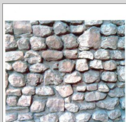
Fig. 1 - Muratura in pietrame fortemente degradata per erosione e decoesione dei giunti di malta. Il degrado avanzato delle malte può provocare il distacco dei blocchi lapidei con instabilizzazione e caduta degli stessi.
